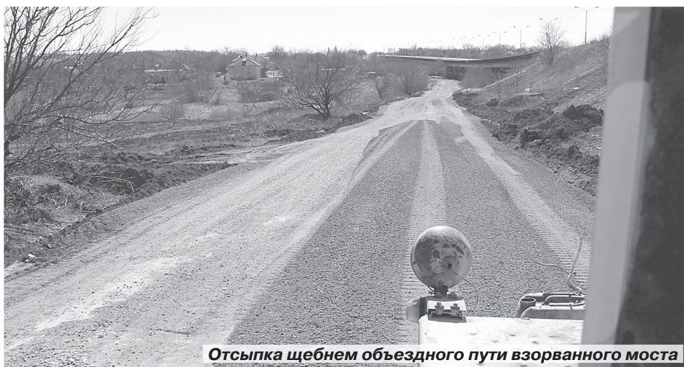
Мост, уничтоженный ВФУ на трассе Донецк – Мариуполь
